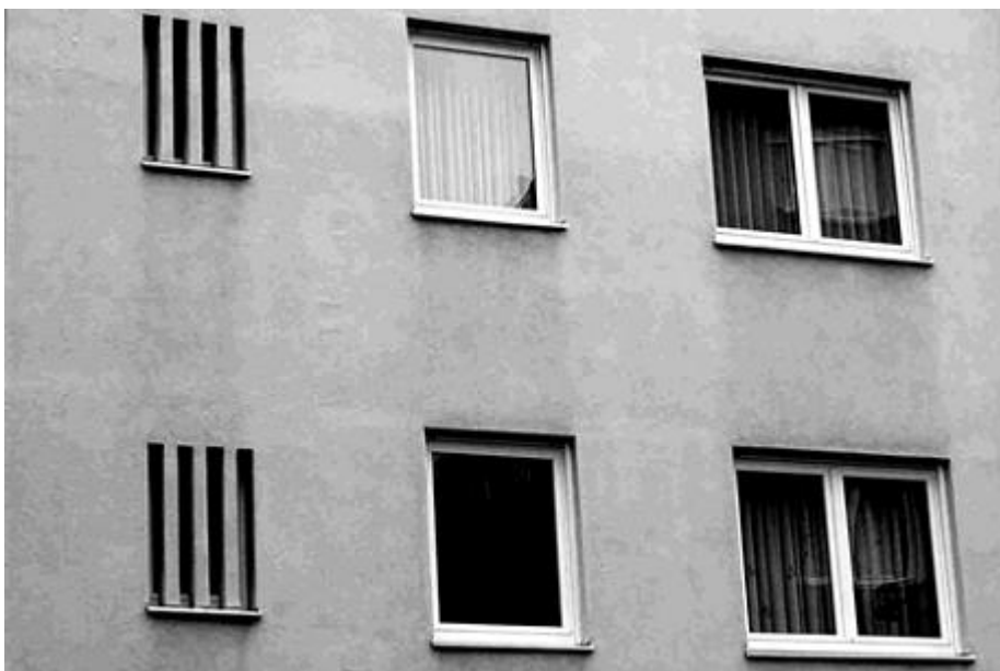
Рис. 5. Частичный вид северного фасада объекта 51 в Нюрнберге, 17 лет после ремонтных работ, заключавшихся в наложении нового слоя покрытия в 1987 году. Участки между окнами, которые подвергаются сильному воздействию дождя, более светлые, что говорит о том, что воздействие дождя на эти участки не привело к образованию водорослей, а носило очищающий характер.
