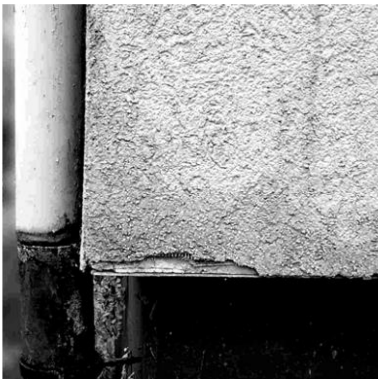
Рис. 9. Пример повреждения нижней части фасада на западной стороне объекта 31, вызванного прониканием влаги в соединительный профиль (возможно, из-за неисправной водосточной трубы). Такой вид повреждения необходимо устранять на ранней стадии и отдельно от ремонтных работ на основном фасаде.
