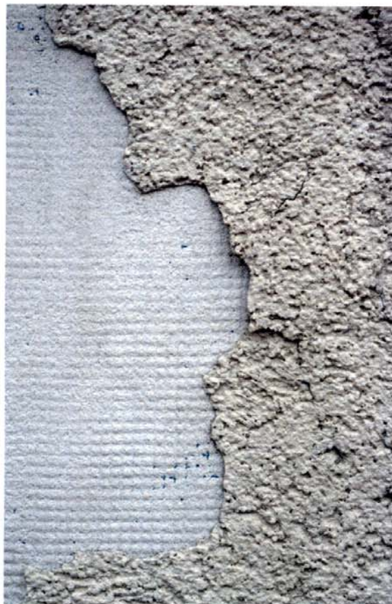
Bild 68 Detailaufnahme aus Bild 67 (Kunstharzputz auf Mineralwolle), die erkennen lässt, dass die Putzablösung zwischen Armierungsputz und Kunstharzputz aufgetreten ist.
