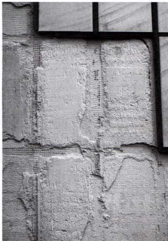
Bild 70 Detailaufnahme einer infolge Frosteinwirkung abgelösten Fliesenbekleidung auf WDV-System. Deutlich zu erkennen ist, dass in den Fugenbereichen der Klebemörtel stärker geschädigt ist. Dies deutet darauf hin, dass eingedrungene Regenfeuchte die Ursache des Frostschadens war.
